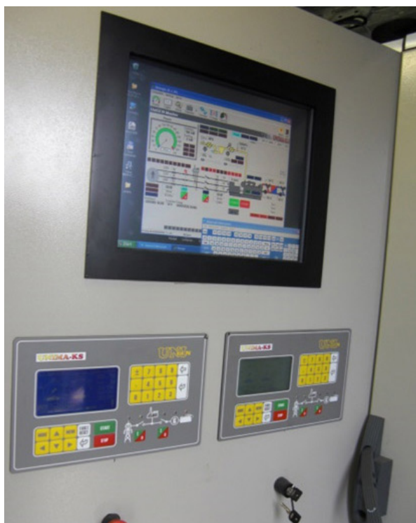
Control panel in Gyál.
